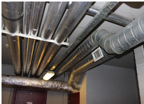
Ventilācija telpa zem tribīnes bez rekuperācijas
