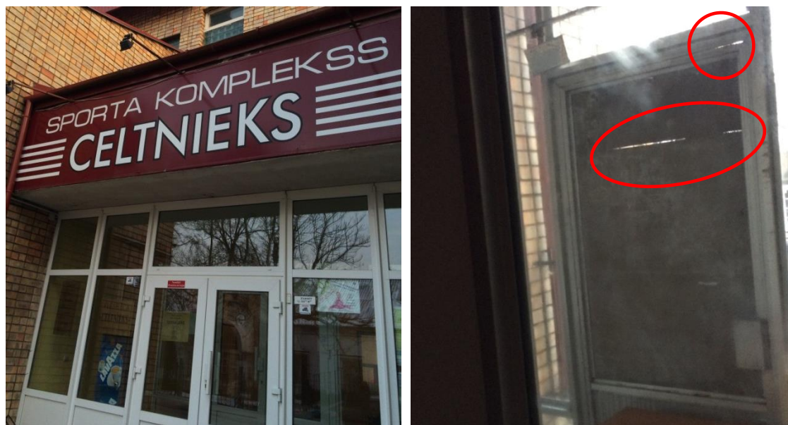
2.13.attēls: Jaunās ieejas durvis un vecās metāla durvis. Ir novērojamas spraugas konstrukcijā
